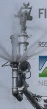
VÁLVULAS DE CONTROLE PARA O CENTRO DO PIVÔ
